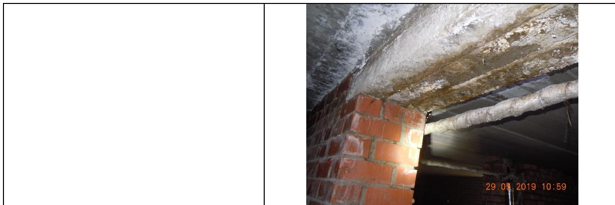
Fotofiksācija Nr.229 Telpa b/n, telpu grupa b/n Mitruma radīti bojājumi, vizuāli redzama ūdens pilēšana
